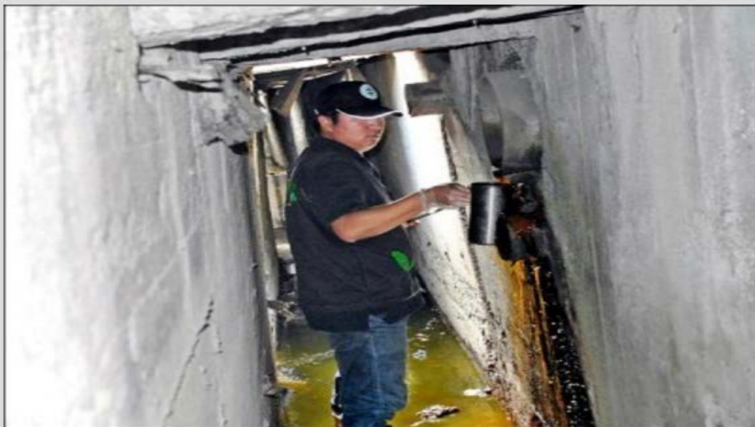
蘆竹區泰橋公司因電鍍槽體破裂，強酸性的鉻酸藥水流出廠外，污染南崁溪。（環保局提供）
